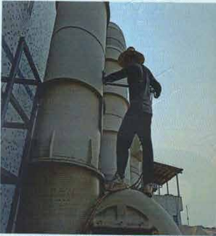
DA014 废气处理后采样口
