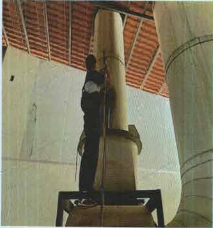
DA001 废气处理后采样口
