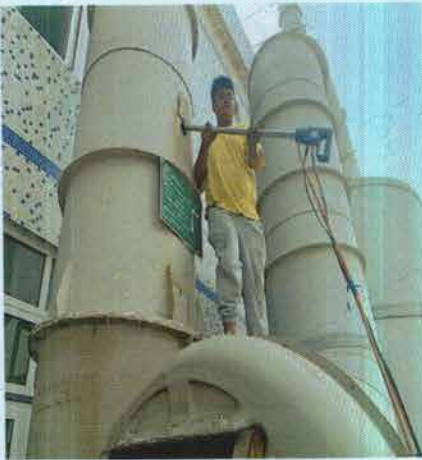
DA020 废气处理后采样口
