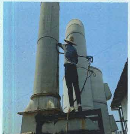
DA003 废气处理后采样口
