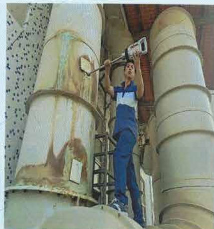
DA015 废气处理后采样口
