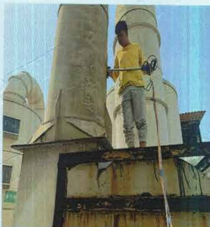
DA008 废气处理后采样口
