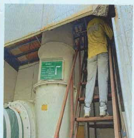
DA019 废气处理后采样口
