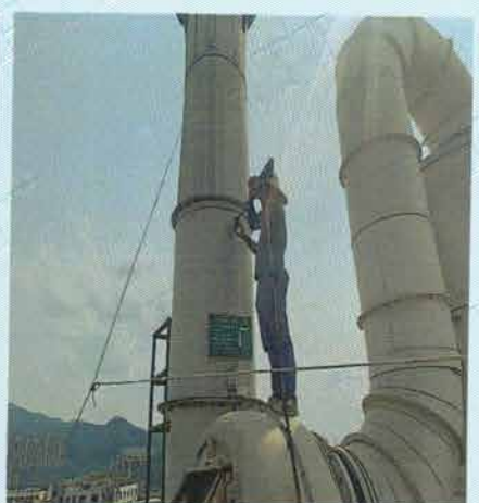
DA013 废气处理后采样口
